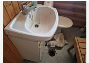
Wc-saunan pukuhuoneen lattiakaivo
