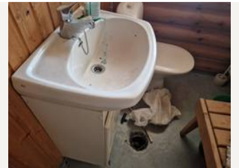
Wc-saunan pukuhuoneen lattiakaivo
