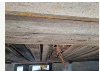
WC-saunan pukuhuoneen rossipohjan vuoto/korjaustarve
