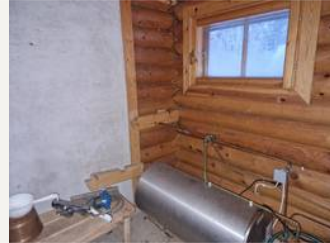
sauna/ph lämminvesivaraaja ja laudepaikka
